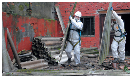
Bauarbeiter entsorgen eine sogenannte „Berliner Welle“ als Sondermüll. Dieses Material war früher fast immer asbesthaltig.
